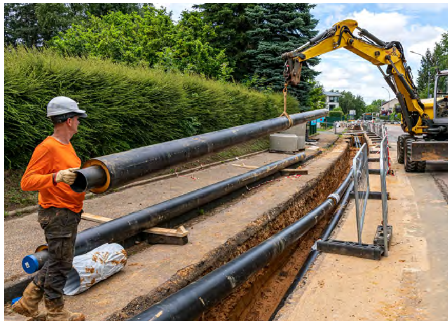
Die Bundesregierung plant, die Fernwärme bis 2045 stark auszubauen und ihren Energiemix im Sinne des Klimaschutzes weiter zu dekarbonisieren
